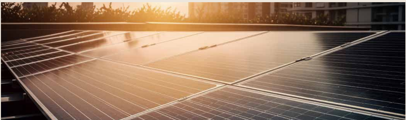
GENERACIÓN PROPIA SOBRE LA AZOTEA
